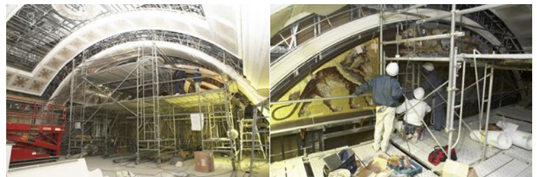
(写真左) 新・本店13階レストラン・大広間空間への再現工事の様子 (写真右) 修復した壁画の取り付け工事の様子
